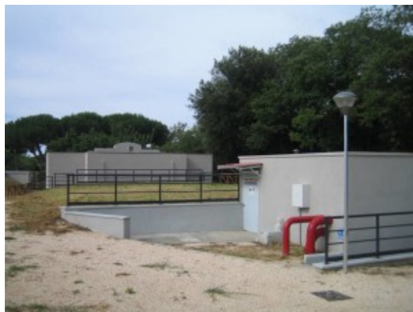
Centro Idrico Le Piagge di Genzano
