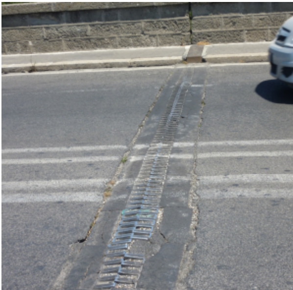
Degrado Ponte Monumentale Ariccia
