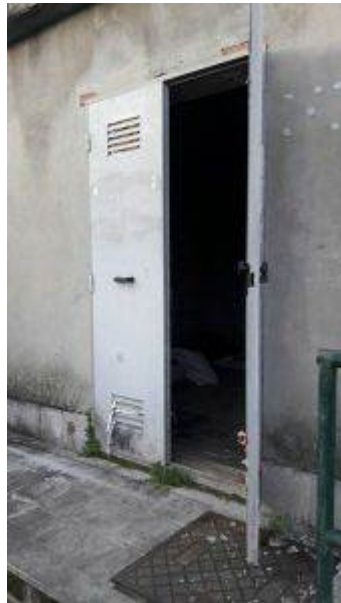
Albano, cabina elettrica aperta a via Tenutella
