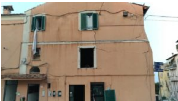
Lo stabile danneggiato dallo scoppio di due bombole di gas a Genzano
