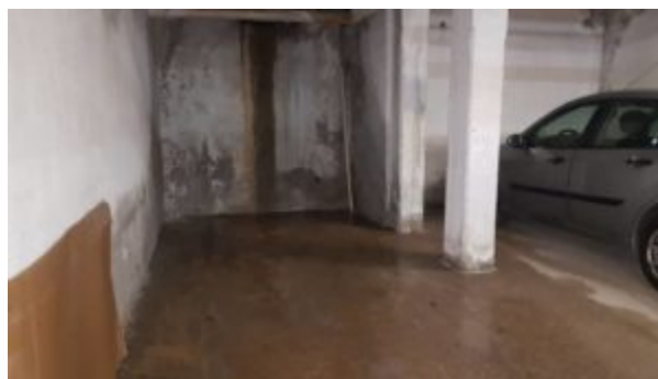
Degrado palazzine via Prati a Marino
