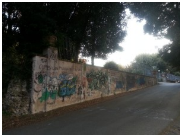
Degrado di Villa Sciarra a Frascati
