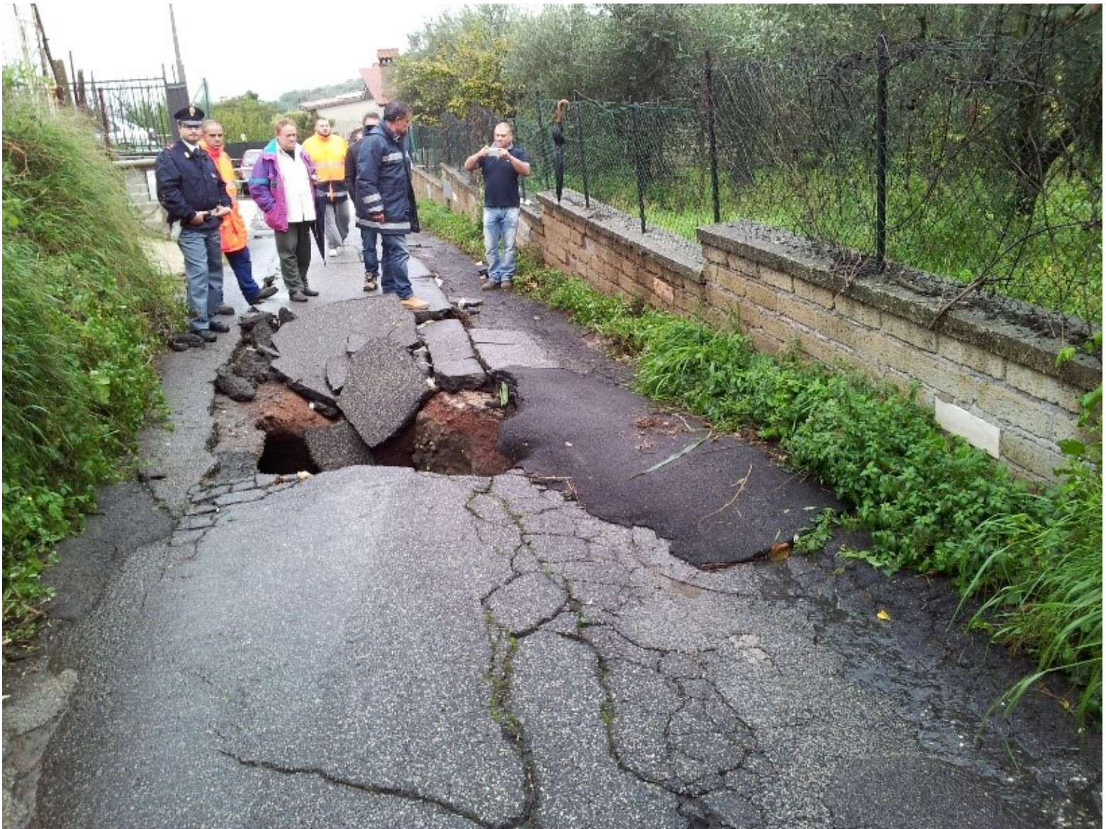
Aperta voragine in via Vivaldi a Marino, dalle 48 ore ai 5 giorni per riparare
